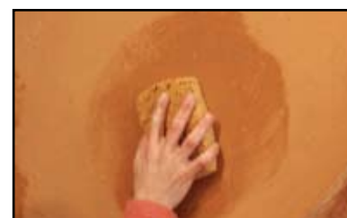
Etape 5 - une fois l'enduit sec, passage d'une éponge semi-humide afin de faire tomber les poussières de surface et faire ressortir le lin.
